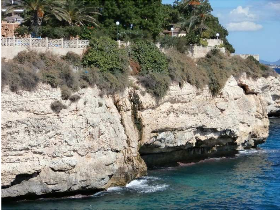
Foto 9 – Vista general dels vessament d'aigües fecals properes a la fita 1.036
