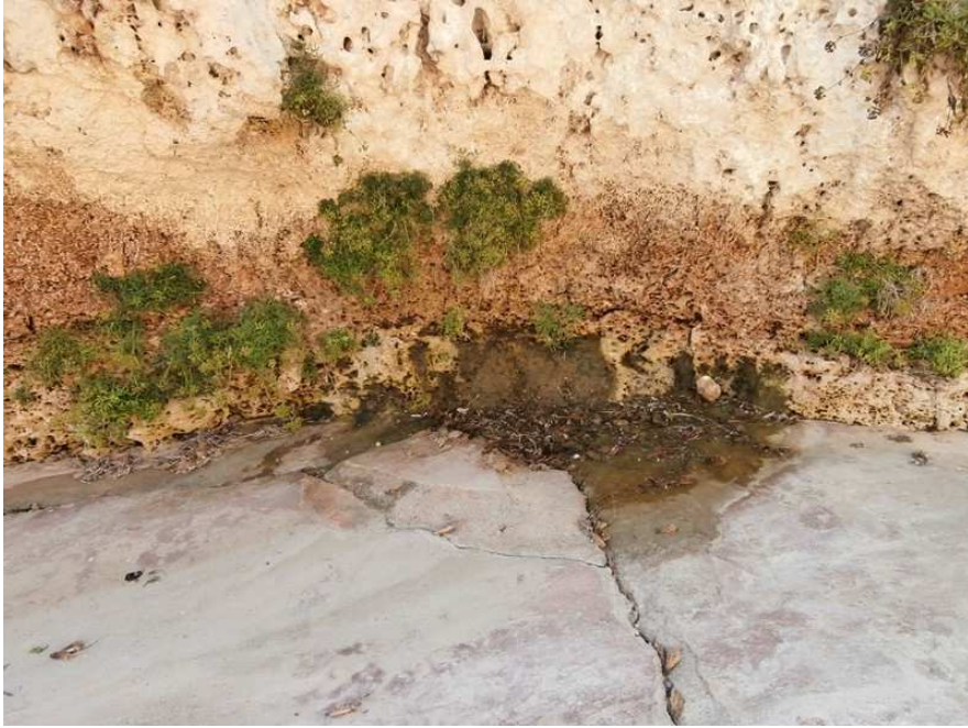
Foto 5 – Vista d'un dels punts de vessament d'aigües fecals al penya-segat
