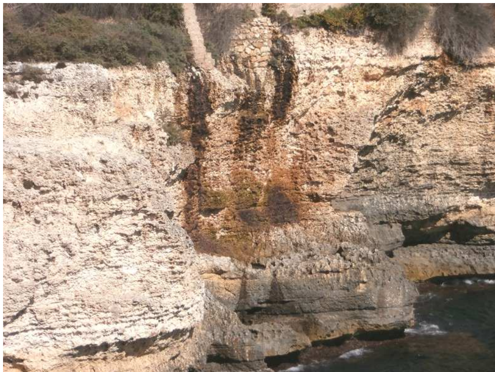
Foto 8 – Detall dels vessament d'aigües fecals properes a la fita 1.037
