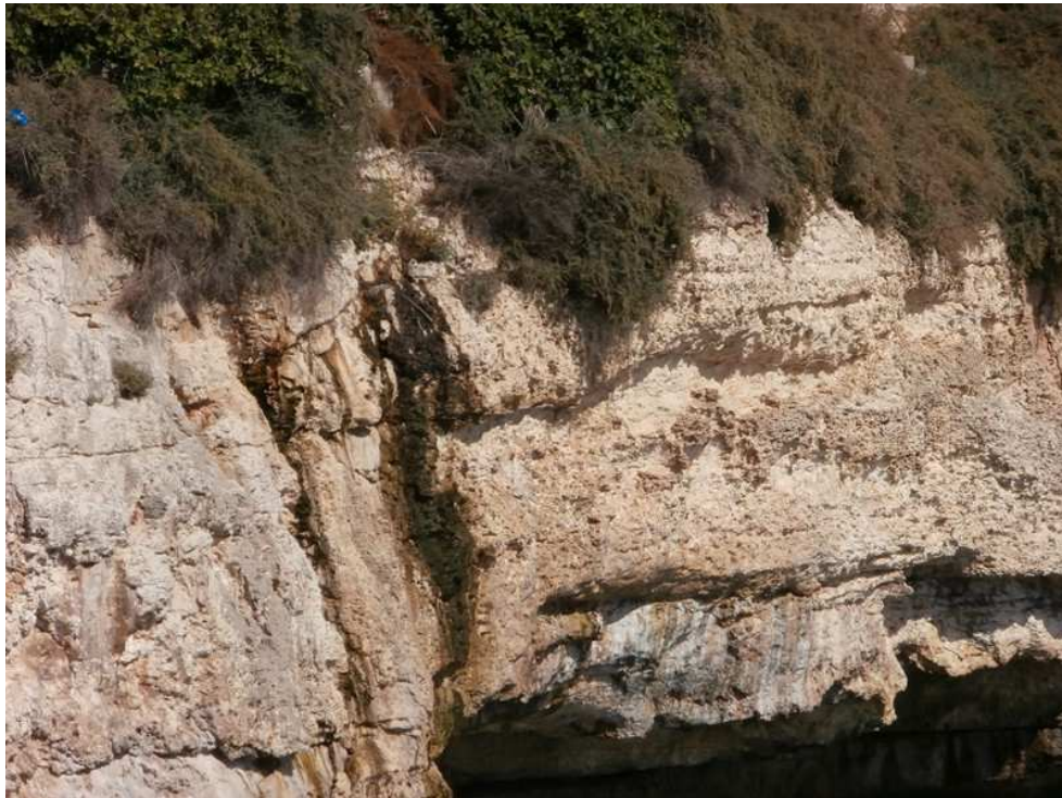
Foto 10 – Detall dels vessament d'aigües fecals properes a la fita 1.036
